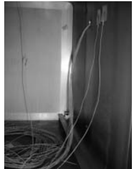
Die Temperatur an der Kammerwand wird durch zwei Fühler gemessen.
